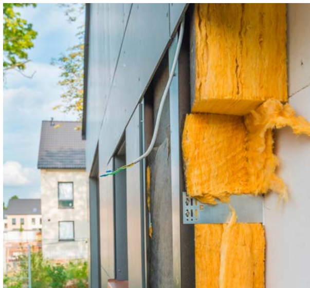
Hinterlüftete Fassade mit Mineralwolldämmung.
