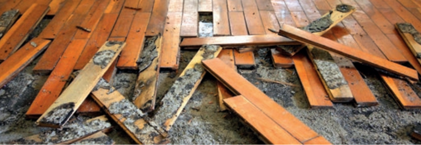
48 Schäden durch Stauwasser
